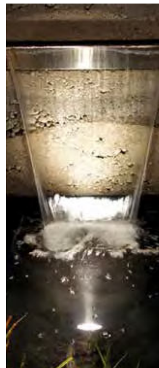
Brunnenbeleuchtung mit Maxispot
